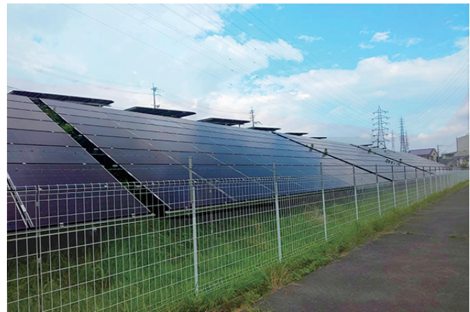
↑法面に設置された太陽光パネル
